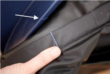
Abb. 9: Markierung auf Ventilator mit Pfeil markiert
